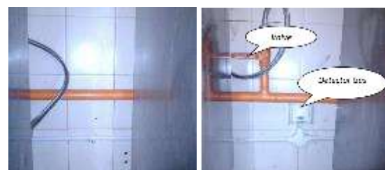
Gambar 1. Sebelum (kiri) dan setelah (kanan) pemasangan valve dan gas detector Sumber: data primer, 2016
