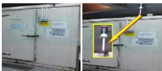
Gambar 3. Sebelum (kiri) dan setelah (kanan) pemasangan alarm pada Chiller and Freezer Sumber: data primer, 2016
